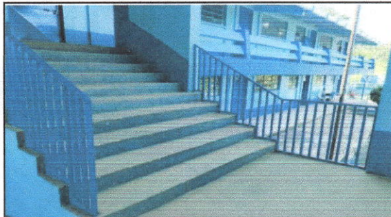
FOTO 4: SITUACION ACTUAL DE BARANDAS EN MODULO DE GRADAS
