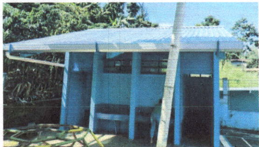
FOTO 1: ESTADO ACTUAL DEL TECHO EN MODULO DE BAÑOS
