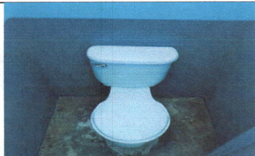
FOTO 3: ESTADO ACTUAL DE ACCESORIOS EN TANQUE DE INODORO
