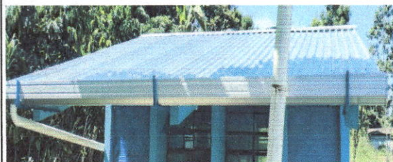
FOTO 2: ESTADO ACTUAL DE CANAL Y BAJADAS DE AGUA EN MODULO DE BAÑOS
